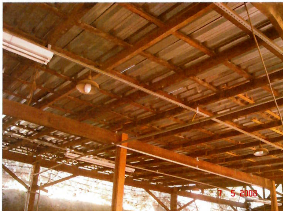
Figura 11. Sistema de iluminação da marcenaria
